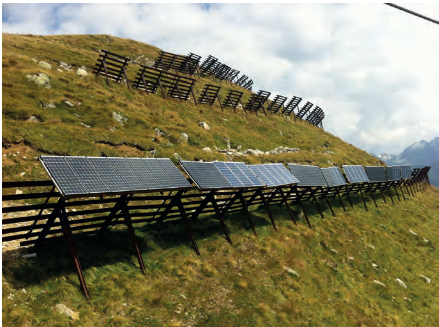
PV auf Lawinverbauung in Bellwald VS. Bild: EnAlpin AG
